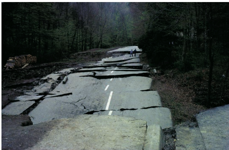
Figura 1.2. L'esempio della frana di Chenaulaz (1983) che ha comportato la distruzione della strada che collega Pully a Belmont, a est di Losanna, Svizzera. Foto Geolep, J.H. Gabus
