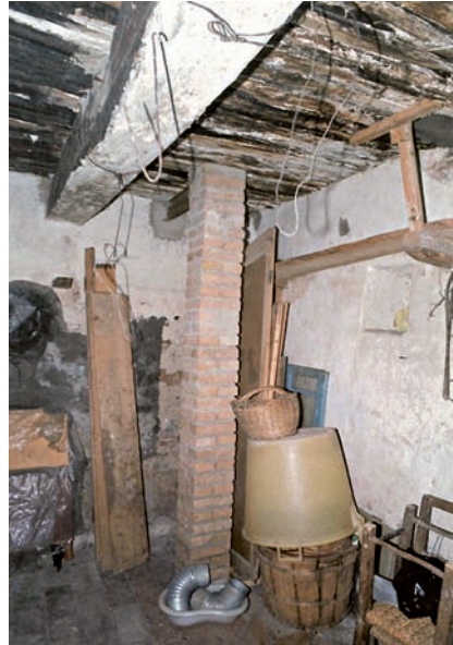
Figura 1.24 Ambito antico, solaio ligneo degradato, con puntellatura provvisoria in mattoni
