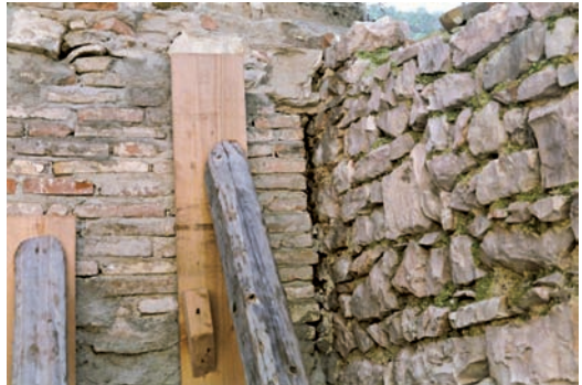
Figura 1.11 Muratura ad angolo in cui si rileva l'assenza di ammassatura
